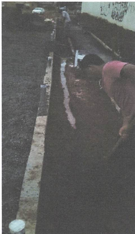
Foto 06 - Infra estrutura – Mangueiras
