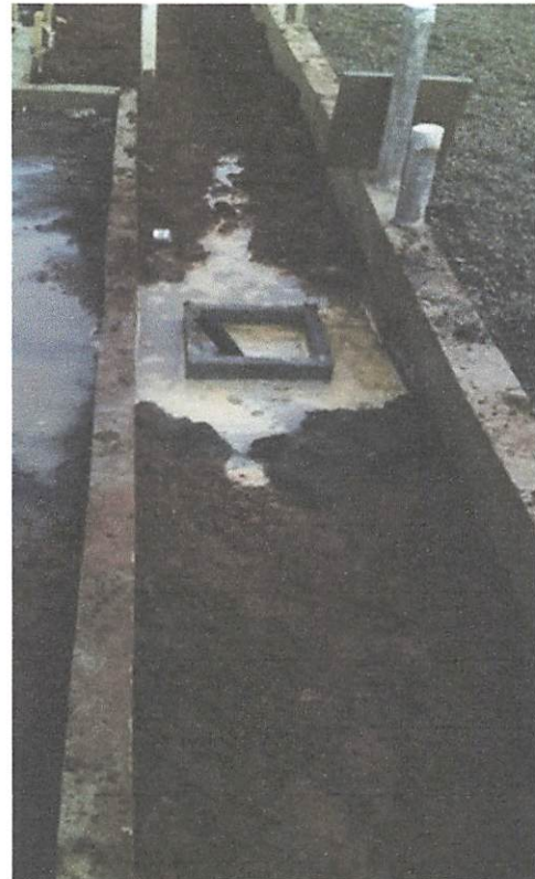
Foto 07 - Infra estrutura – Caixas
